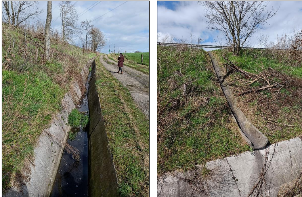
Figuur 22: Gebetonneerde grachten langs de E429 die het afstromend water van de autostrade doorvoeren naar de Meerbeek.
